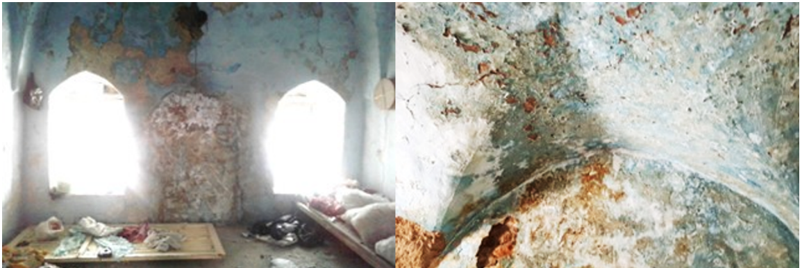
Şekil 17: K-02 ve K-03 oda sıva dökülmeleri (Karahana,2025)
