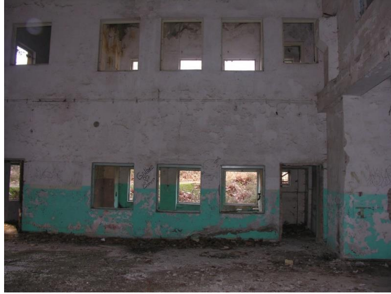
Ek 7. Gökpınar Hidroelektrik Santrali II (İç Görünüş) (2018) (Fotoğraf yazar tarafından çekilmiştir 2018).
