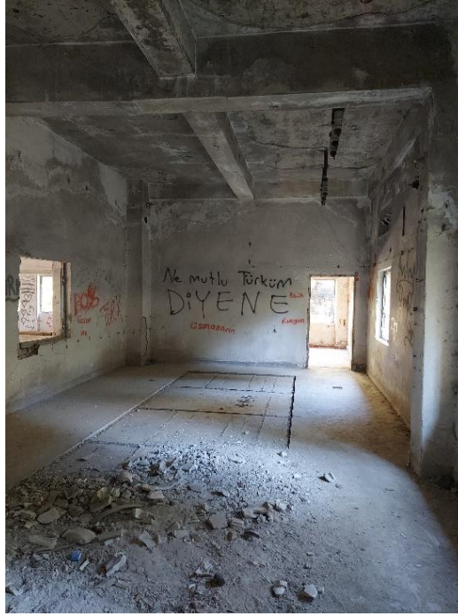
Ek 9. Gökpınar Hidroelektrik Santrali II (İç Görünüş-Üst kat) (2024) (Fotoğraf yazar tarafından çekilmiştir (2024)).
