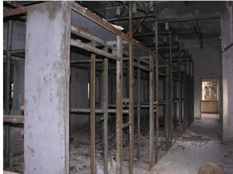
Ek 8. Gökpınar Hidroelektrik Santrali II (İç Görünüş-Üst kat) (2018) (Fotoğraf yazar tarafından çekilmiştir 2018).
